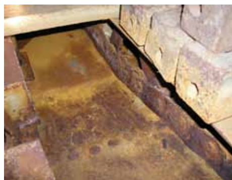
Ruostevaurioita pilssin pohjassa.
