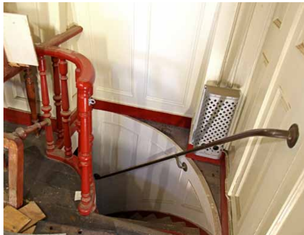
Päällystömessistä alas hyttikannen päällystöhyttien käytävälle (208) johtaa kaareva puuporras. Porras ei ole ollut museoyleisön käytössä.
