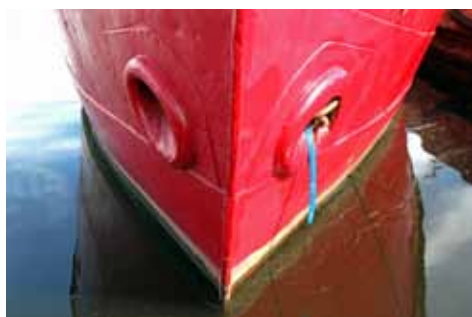
Keulan klyssiputken aukosta on johdettu pilssipumpun vesiletku. Kyseessä on tilapäinen ratkaisu.
