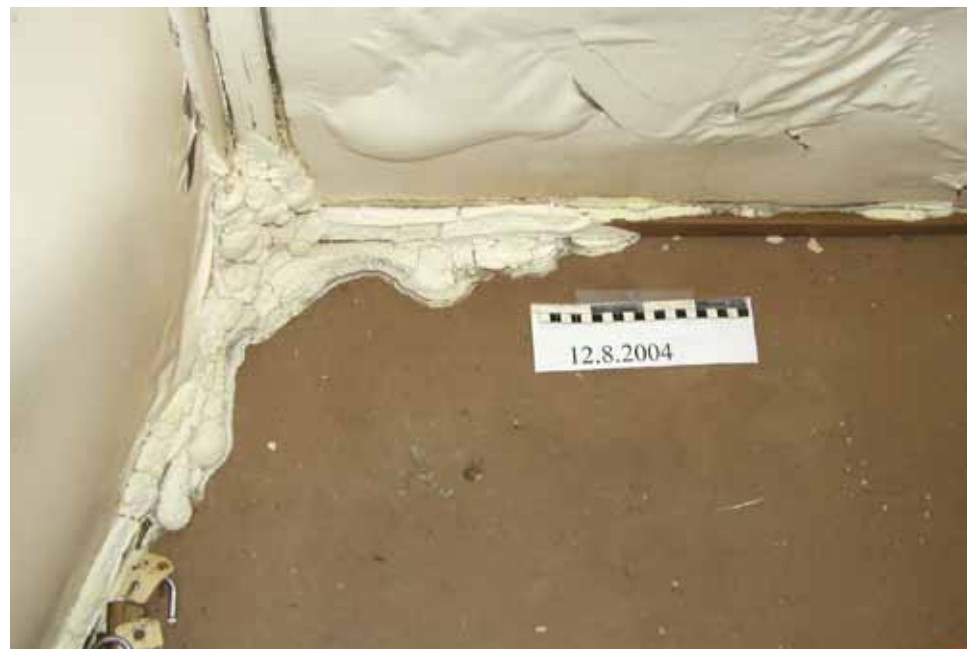
Vesivauriot ja sisätilojen huono ilmanvaihto ovat muodostaneet lahottajasienille ja homeille oivaliset kasvuolosuhteet.
