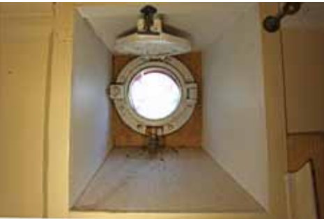
Tähtikuviodut valoventtiilit jäävät syväälle ulkoseinärakenteen sisälle. Venttiilit ovat vuotaneet ja vaurioittaneet korkkieristeitä.
