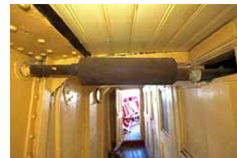
Käytävän poikki matalalla kulkeva pakoputki tulee sähkö- ja sireenihuoneesta (204) olevan generaattorin moottorista.
