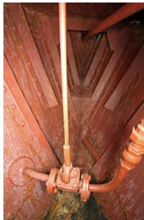
Keulavaraston (008) seinät ovat punaiset. Lattiassa on betonikerros. Katto on ruostunut puhki.
