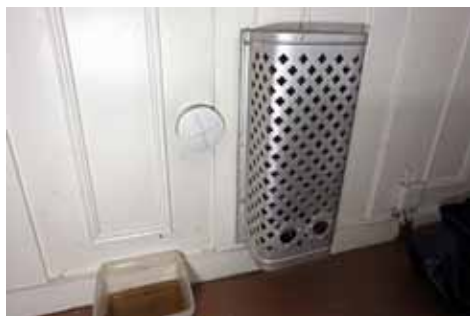
Reikäkuvioitu alkuperäinen (1901) patterin kuori. Patterit ovat alun perin olleet höyrypattereita ja lämpöjohdoissa on kiertänyt kuuma höyry. Nykyisin vanhojen kuorien sisällä on sähkövastukset, jotka on asennettu osin vuosien 1986–1988 aikana ja osin vuonna 1995.
