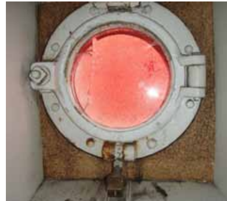
Valoventtiileistä vuotanut vesi on vaurioittanut korkkieristettä. Kuva on otettu 10.9.2007.
