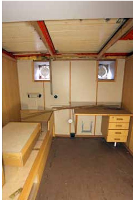
Tutkijahytin (104) katossa on näkyvissä punaiset teräspalkit ja pääkannen lankkujen alapinnat. Kuvassa oikealla näkyvä ikkuna on puhkaistu ilmeisesti vasta vuonna 1956 ja se sijaitsi emännän hytissä.
