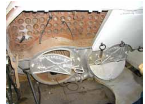
Pilssissä sijaitsevan konehuoneen (002) höyrykattila, joka on asennettu vuonna 1923.
