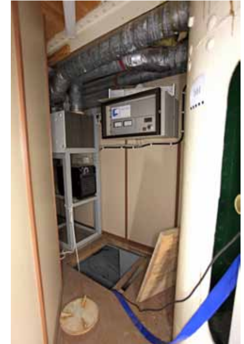
Tekniseen tilaan (101) on sijoitettu erilaisia sähkö- ja ilmanvaihtolaitteita. Lattialuukusta pääsee alas ruumaan (005).
