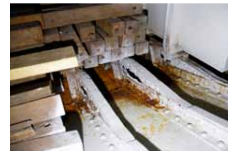
Pilssin pohjan ruosteaurioita vuonna 2018. Kuva: Tehnomet / SMM, käsiarkiston digitaaliset aineistot.
