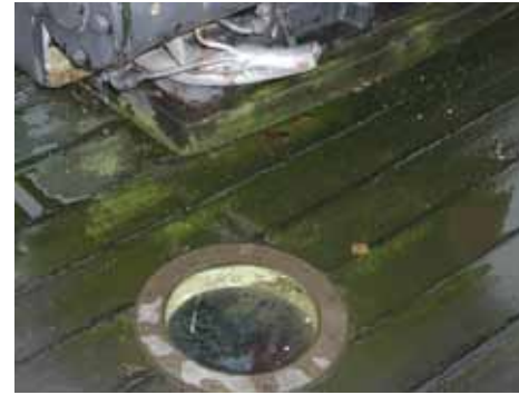
Sääkansi vuosi monesta kohdin ja sen lankuis- sa kasvoi levää. Saumauksissa oli vaurioita.
