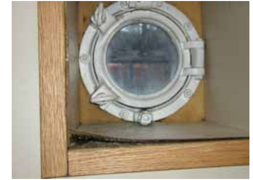
Hyttikannen majoitustilojen asuinhytin valo- venttiilin vuotaminen on aiheuttanut ikkuna- laudan levyn turpoamisen.
