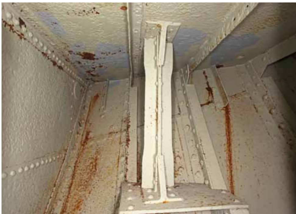
Painolastitankin vaaleanharmaassa maalipinnassa on paikkamaalauksia ja pintaruostetta. Molemmilla laidoilla on teräksiset tukipilarit.
