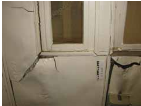
Pääkannen luotsihytin käytävän puoleinen laho seinä.
