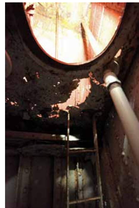
Kuva on otettu ylöspäin kohti hyttikannen petrolisäiliötä (112). Katto on ruostunut pitsimäiseksi.
