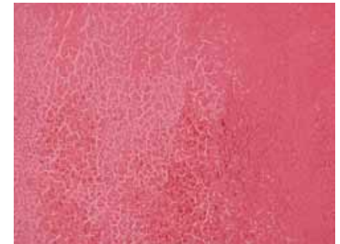
Ulkosivun hilseilevää maalipintaa.
