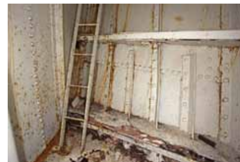
Teräspinnoissa on ruostevaurioita.
