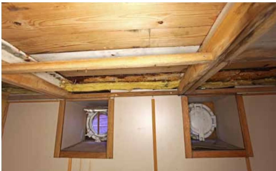
Kaikkien tutkijahyttien (104, 105 ja 107) alakattoja on jouduttu purkamaan vesivaurioiden vuoksi ja kannen korjaukseen liittyen.
