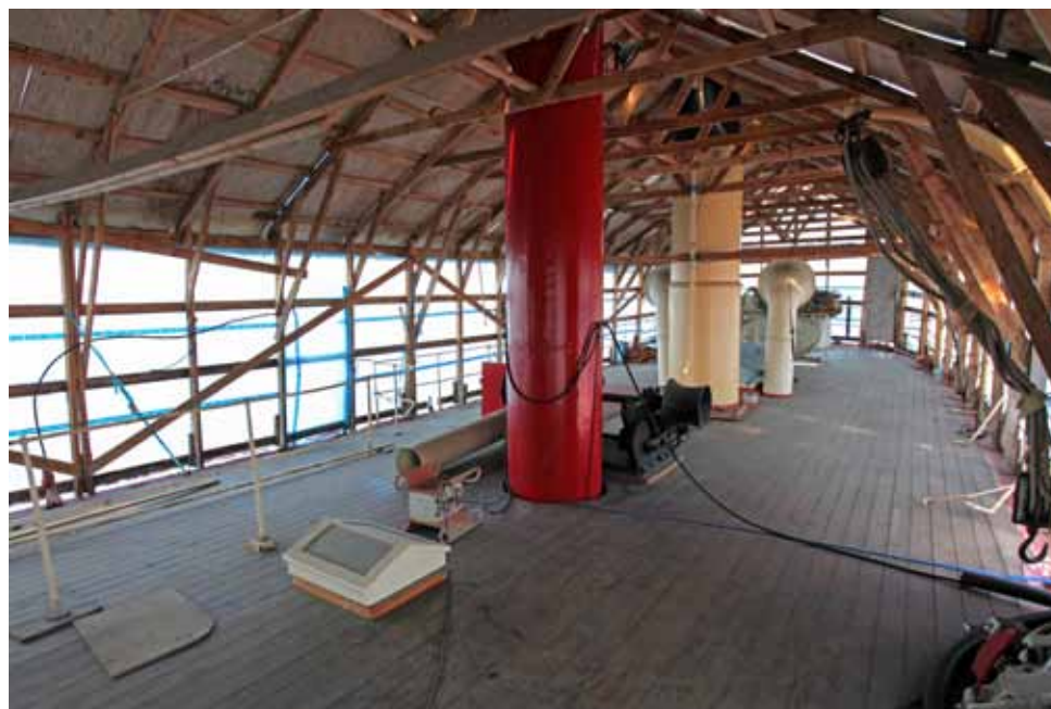
Keskikansi (301) kuvattuna perää kohti. Keskellä näkyy punaiseksi maalattu loiston jalka. Irroitettua valaisinosaa säilytetään tällä hetkellä Suomen merimuseossa.
