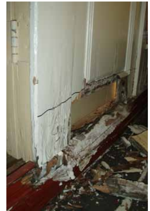
Sääkansi oli vuotanut ja osa pää- ja hyttikansien puurakenteista oli pahoin lahonnutta ja homehtunutta.
