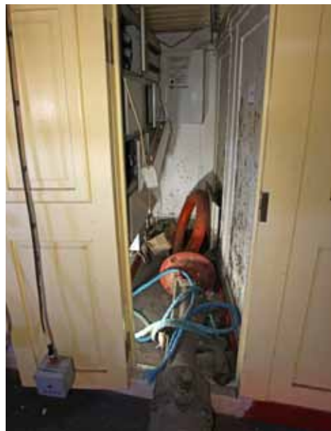
Sähkötila (206) on pieni ja kapea tila, joka on aluksen sähkö- ja turvavalaistuskeskus.
