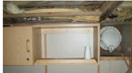
Hyttikannen majoitustilan kattoon 1980-luvulla asennetut mineraalivillat olivat homehtuneet. Kuva on syyskuulta.2007.
