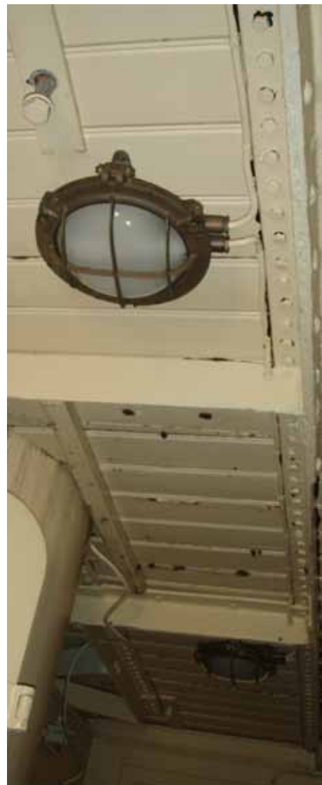
Vuonna 2009 valaisimia kiinnitettiin takaisin kattoon kansien kunnostustöiden jälkeen. Kuva: SMM, käsiarkiston digitaaliset aineistot.
