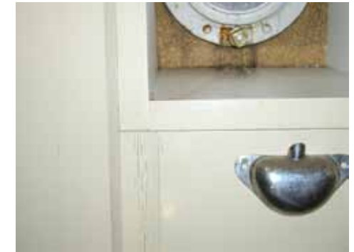
Valoventtiilien valuvalla vedelle ei ole tippako- urua ja poistoputkea. Vesi valuu ikkunalaudalle ja seinään. Kuva on näyttelytilan kapteenin vitriinihyttistä.
