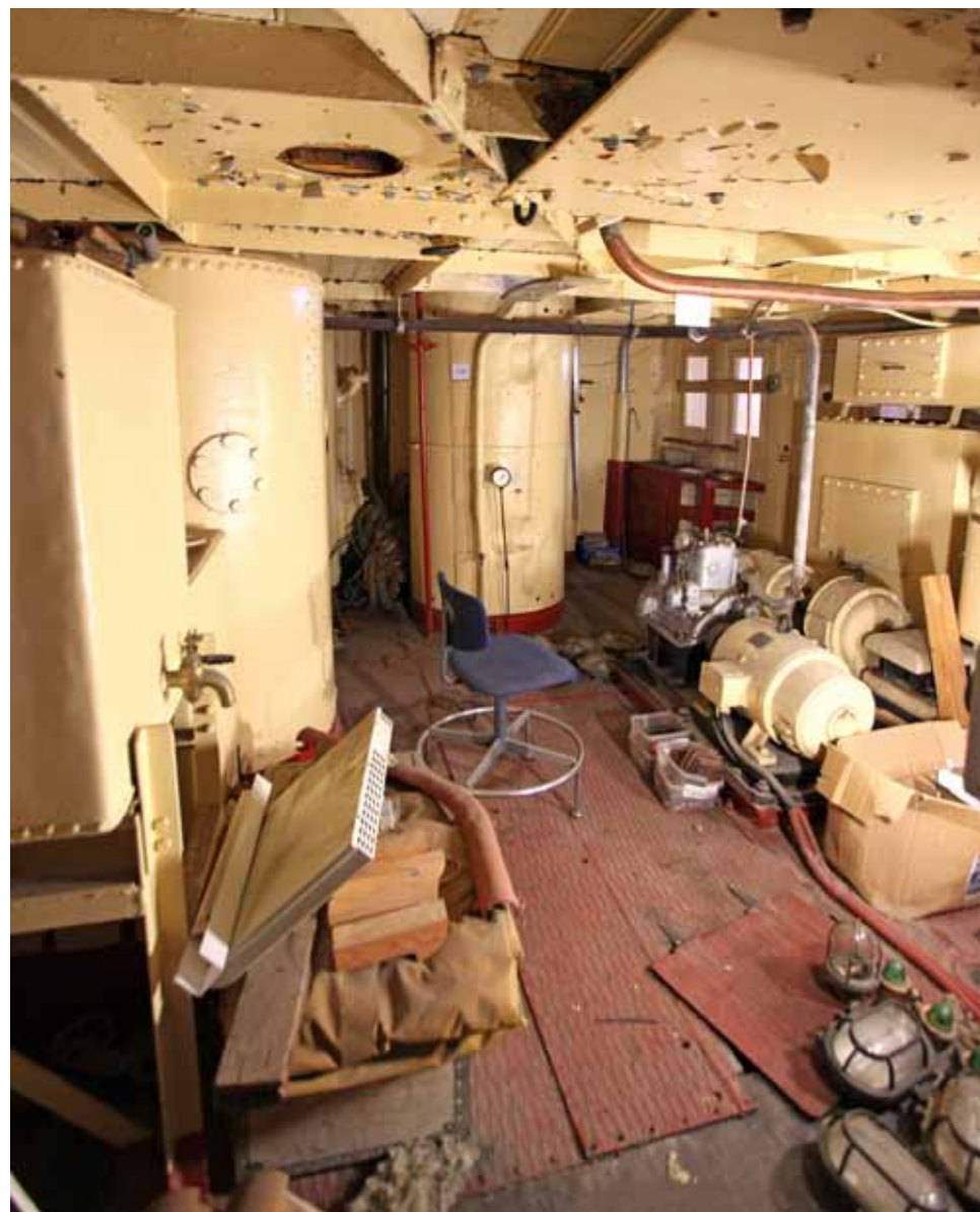
Vasemmalla näkyy toinen höyrykoneen painekattiloista. Keskilinjassa on savupiipun läpivienti ja oikealla sähkögeneraattorilaitteistoa. Lattian perän puoleinen osa on punaiseksi maalattua turkkipeltiä.
