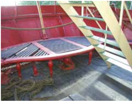
Pääkannen peräkansi (200) ja kvadrantin yläpuolinen puinen kansirakenne. Oikealla on vuosina 1986–1988 rakennettu yleisöporras.
